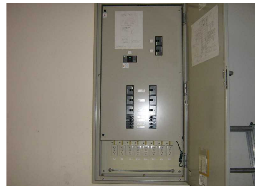
配電盤150アンペア
