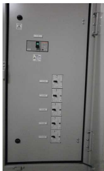
配電盤 3φ200V 125アンペア
