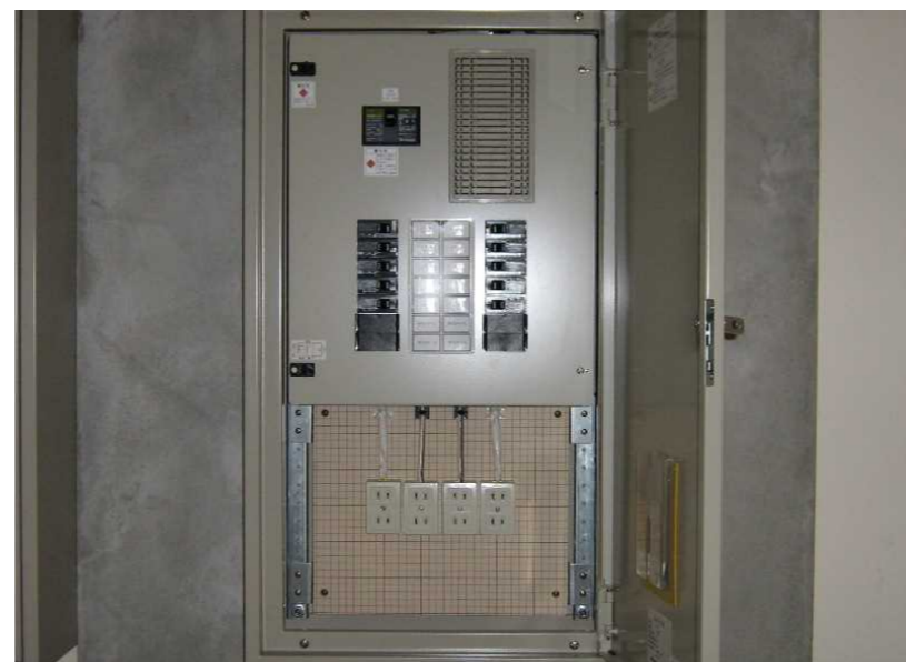
配電盤50アンペア
