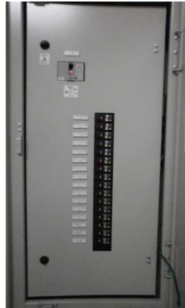
配電盤 1φ 100V/200V 75アンペア(柱天井コンセント用)
