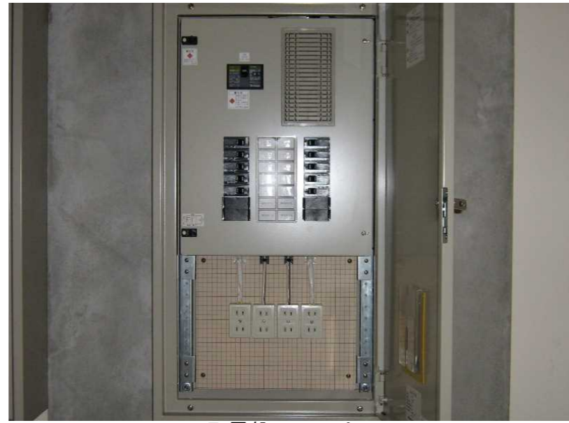
配電盤50アンペア
