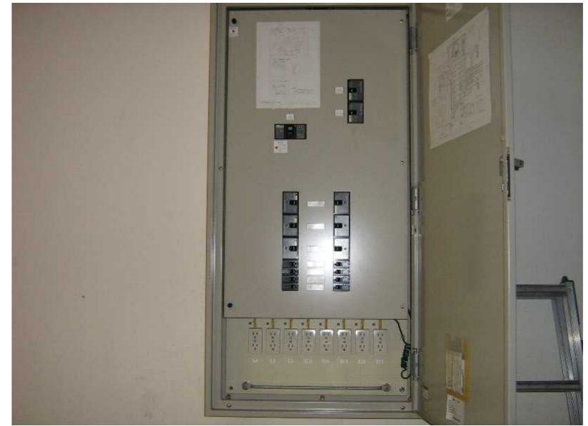
配電盤150アンペア
