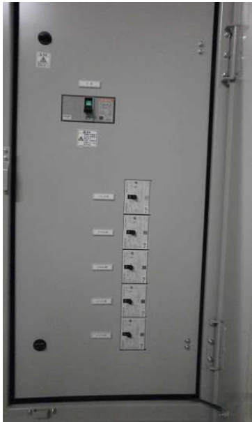
配電盤 3φ 200V 125アンペア
