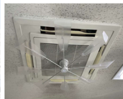
エアコン取付ファン
