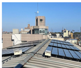
太陽光パネル
