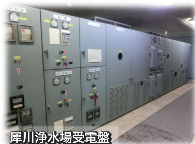
老朽化した水道設備
