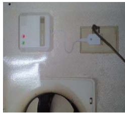
ガス漏れ警報器
