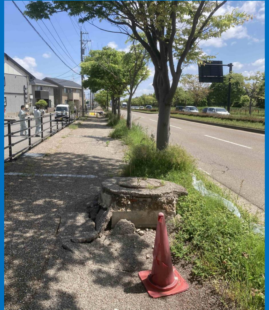
マンホール浮上
