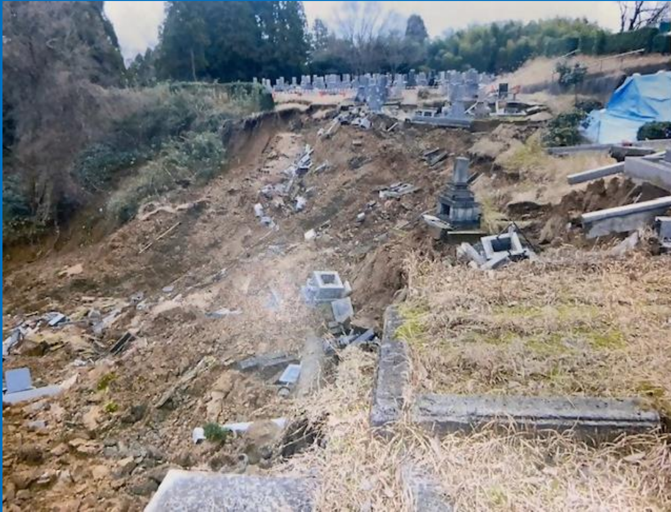
土砂崩落 (奥卯辰山墓地公園)
