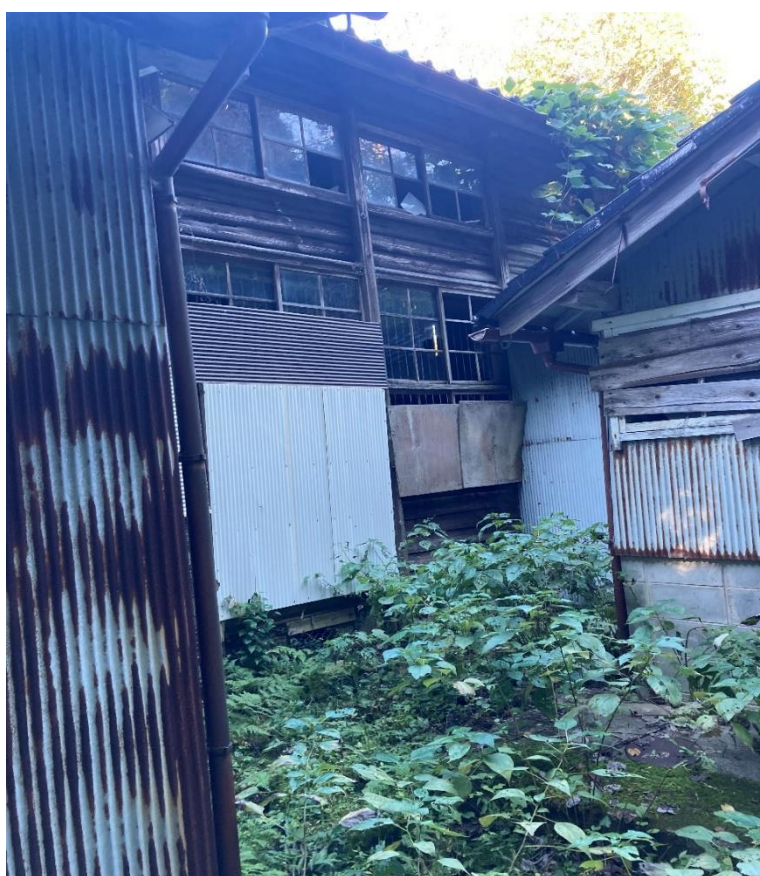
旧小学校の裏側から、ガラス窓が破損した状態
