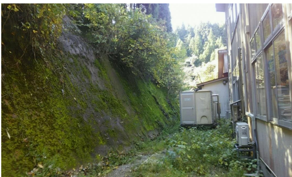
建物裏 給排水施設（左斜面は強固な岩盤で施設の安全性は高い）
