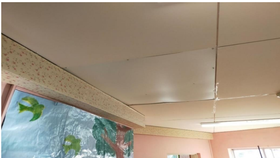
雨漏りで応急対応した箇所
