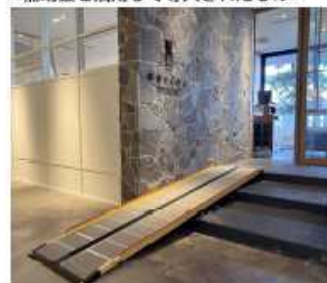
バリアフリー整備 →階段部分にスロープを設置して、車いす等のお客様にもご利用いただきやすい環境が整備されました。
