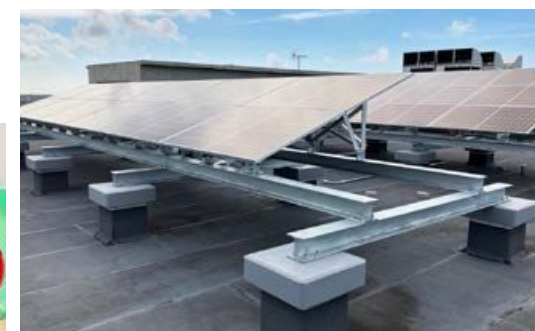
太陽光発電設備の導入
