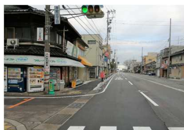
(都)専光寺野田線寺町3丁目～5丁目無電柱化事業 管路及びハンドホール設置 R3
