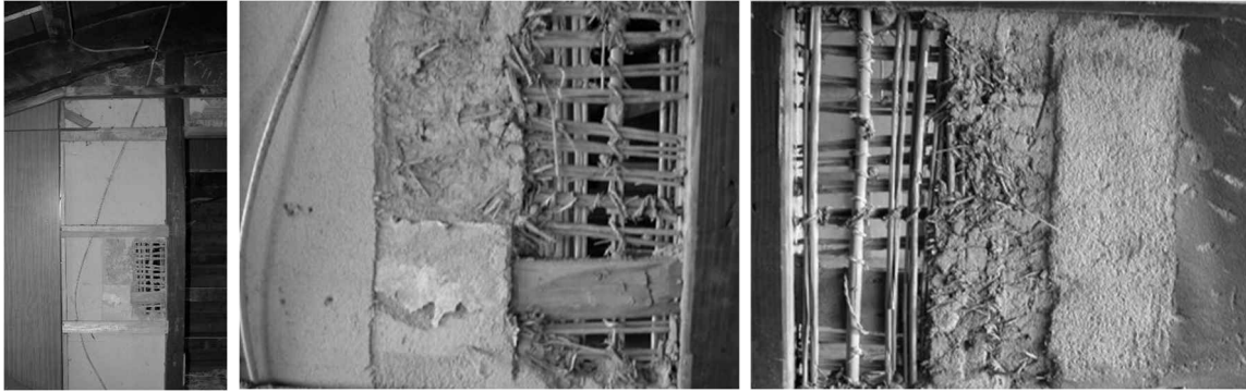
壁の仕様調査・土壁塗層、小舞下地（写真左：全面、写真中・右：部分解体部分の表裏）
