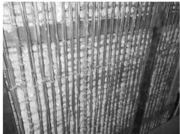
写真5.2 土壁が片面塗りである例
