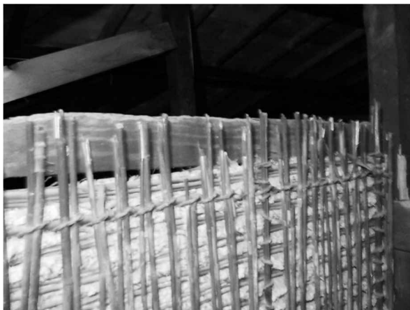
写真5.1 土壁の上部が横架材に達していない例
