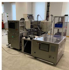
直流制御システム (パソコン、蓄電池、監視制御)
