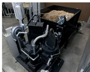
バイオマスシステム
