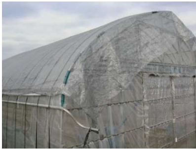
高温期は遮光資材を利用し温度上昇を抑制する
