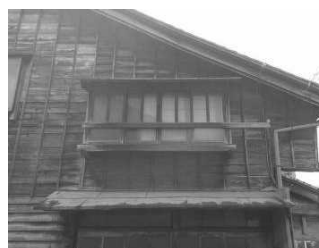
損傷が進む空き町家
