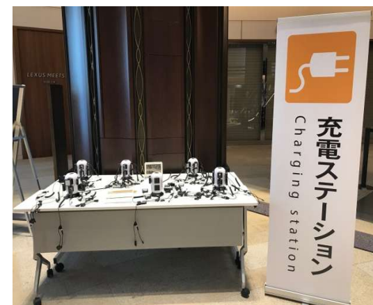
市の非常用発電機等による充電ステーションの設置
