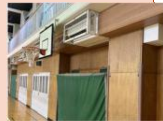
避難所体育館での空調設備推進
