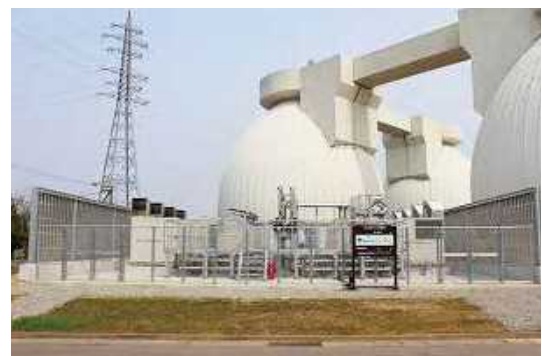
消化ガス発電(城北水質管理センター)
