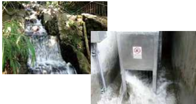
マイクロ水力発電設備(本多公園)
