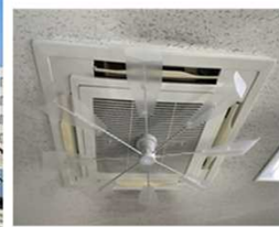
エアコン取付ファン
