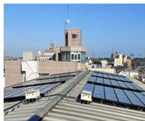
太陽光パネル
