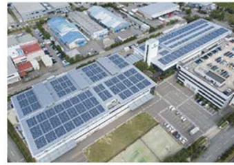
白山工場屋上太陽光パネル
