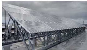
太陽光パネル
