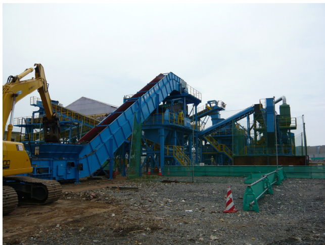
① 中間処理プラント
