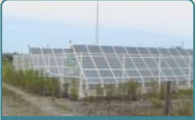
太陽電池パネルを利用した 水質浄化施設
