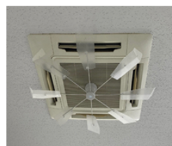
エアコン取付ファンによる空調効率改善
