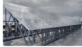
太陽光パネル
