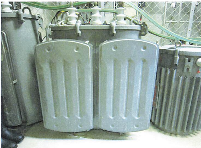
・地下電気室内機器保管状況 (変圧器容量: 三相75kVA)
