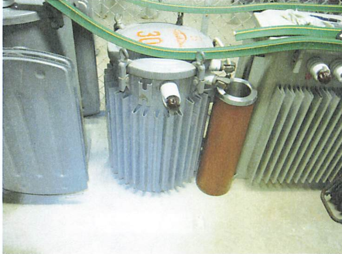
・地下電気室内機器保管状況 (変圧器容量: 単相30kVA)
