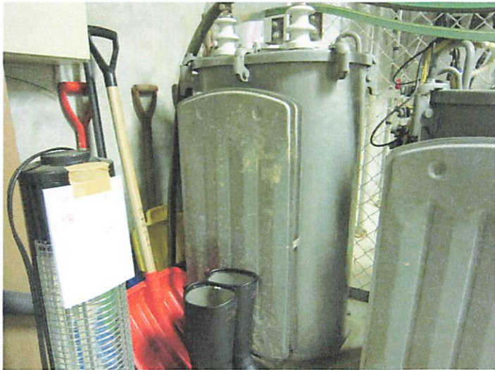
・地下電気室内機器保管状況 (変圧器容量: 単相75kVA)
