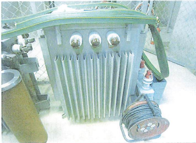
・地下電気室内機器保管状況 (変圧器容量: 三相50kVA)
