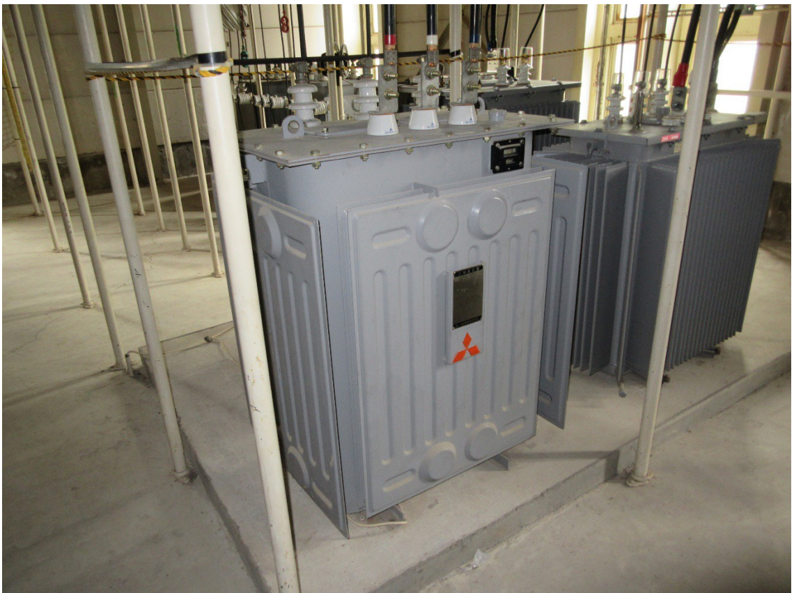
4-004 変圧器 (トランス)
