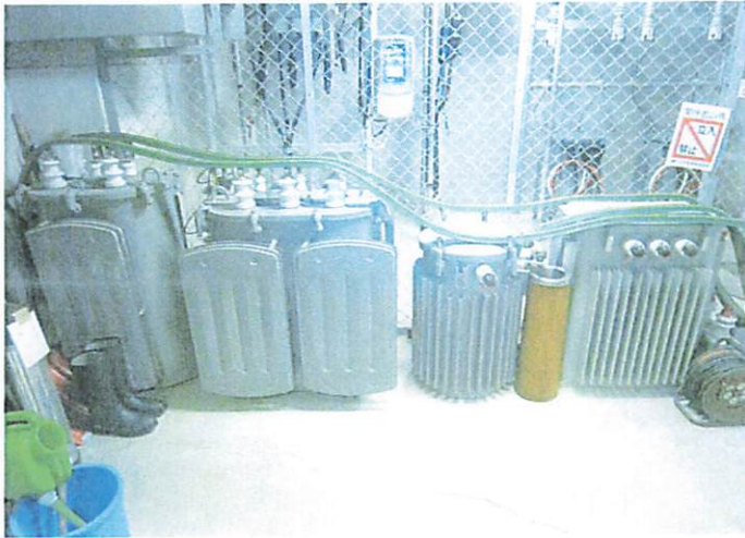
・地下電気室内機器保管状況 (保管機器全台数)
