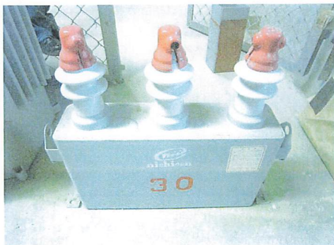
・地下電気室内機器保管状況 (コンデンサ容量: 三相30kVA)
