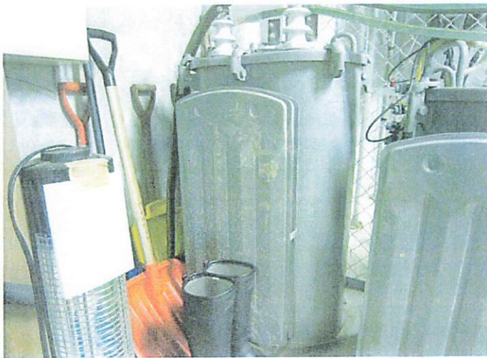
・地下電気室内機器保管状況 (変圧器容量:单相75kVA)
