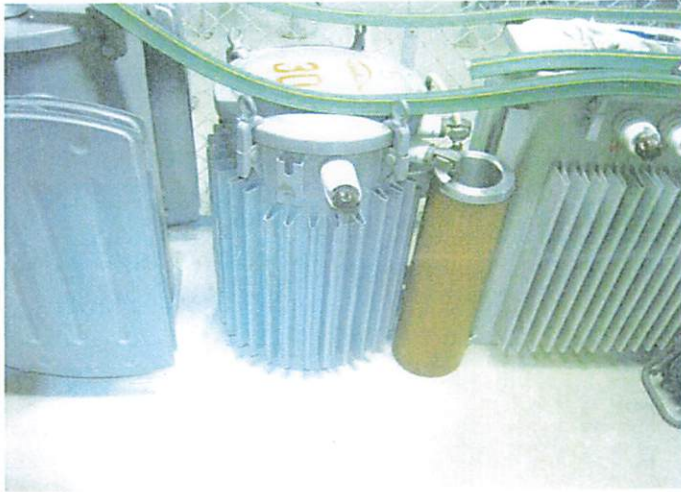
・地下電気室内機器保管状況 (変圧器容量: 単相30kVA)
