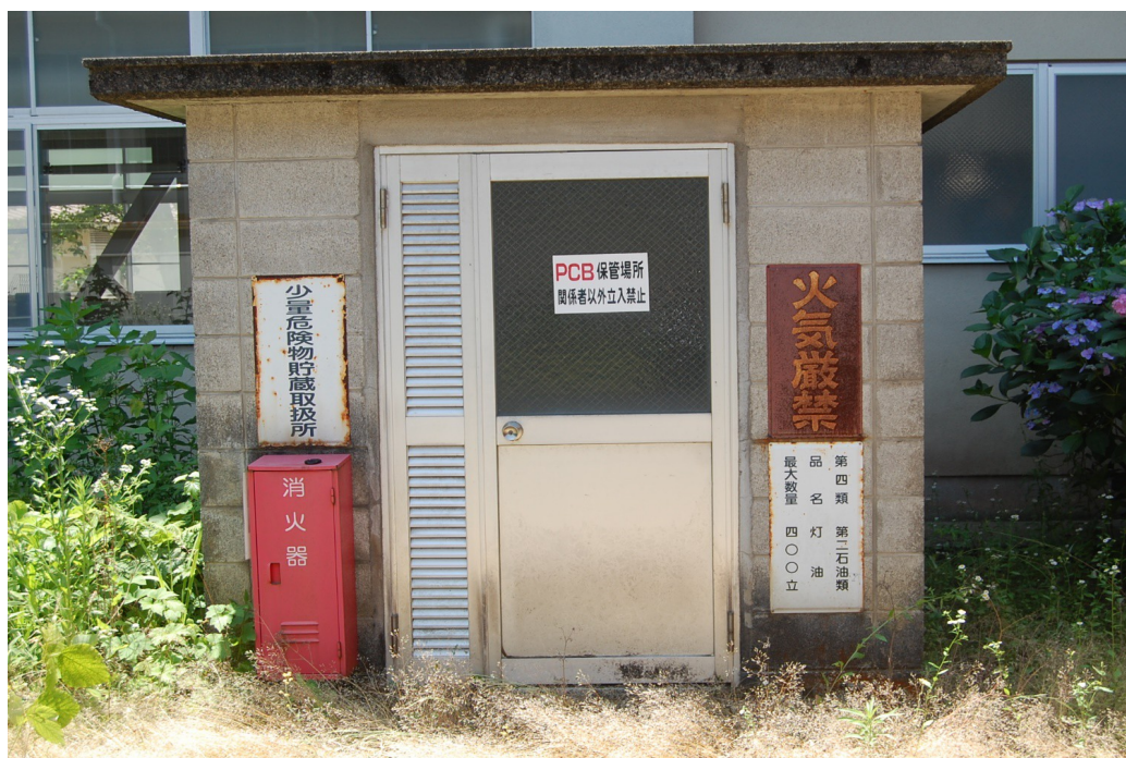
PCB廃棄物保管場所
