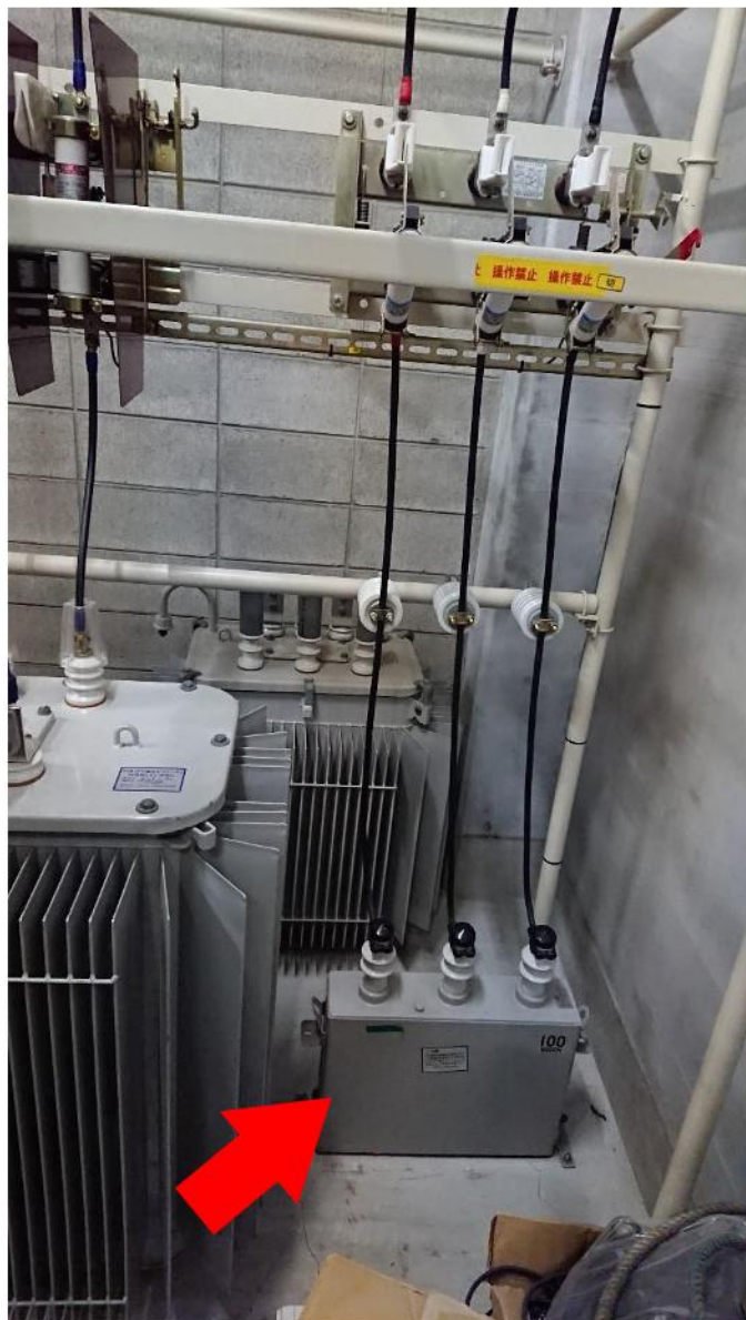
1号館地下 電気室 入口近くのコンデンサ
