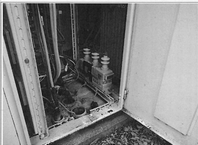
⑤ 高圧進相コンデンサ(PCBの掲示あり、キュービクル内保管) 型式: BRTR-A6J1R 製造番号: 79506012 定格容量: 20kVA 総重量: 16kg 製造年月: 1979.6 製造メーカー: 東京芝浦電気株式会社
