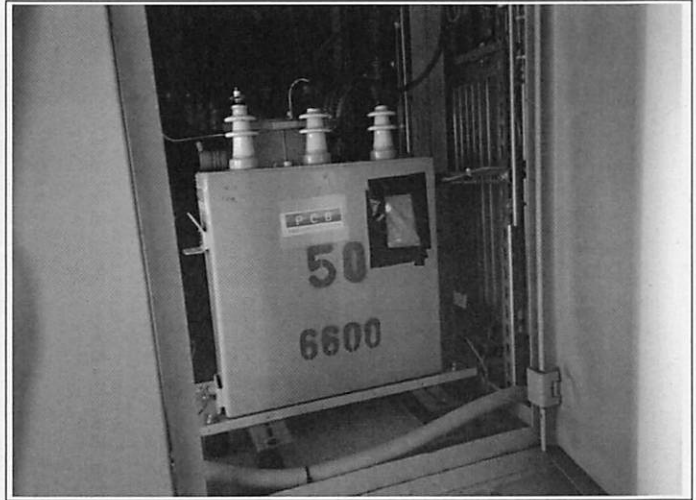
② 進相コンデンサ(PCBの掲示あり、キュービクル内保管) 型式: ORTR-A6CR 製造番号: 72505618 定格容量: 50kVA 総重量: 77kg 製造年月: 1972.7 製造メーカー: 東京芝浦電気株式会社
