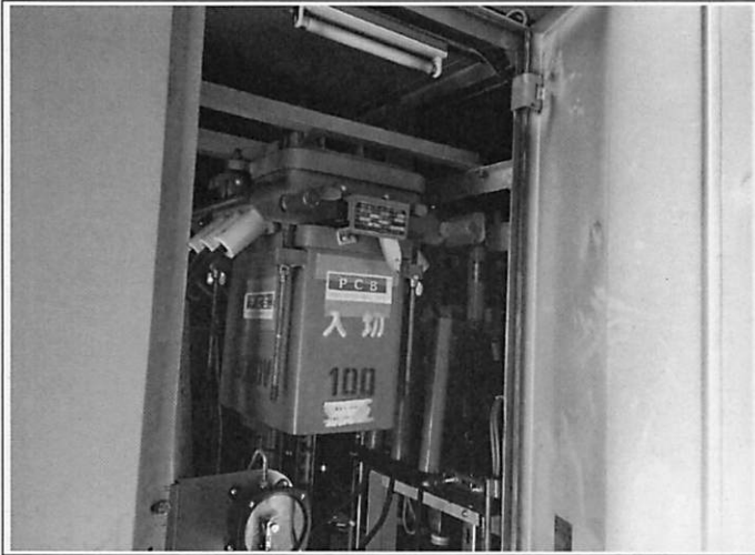
① 高圧油入コンデンサー開閉器(PCBの掲示あり、キュービクル内保管) 型式: DanS-6-K 製造番号: S20024 定格容量: 7200V/100A 総重量: 76kg 製造年月: 1972.1 製造メーカー: 株式会社碍電機製作所
