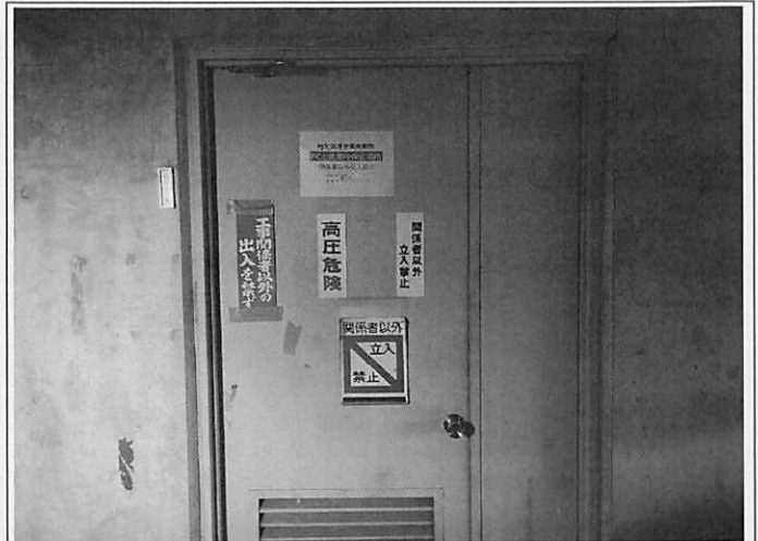
④ ①、②保管状況(PCB保管場所の掲示あり、キュービクル保管室施設管理)
