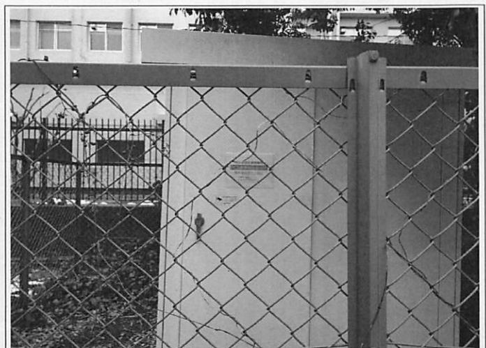
⑥ ⑤保管状況(PCB保管場所の掲示あり、キュービクル施設管理、キュービクル外周フェンス施設管理)
