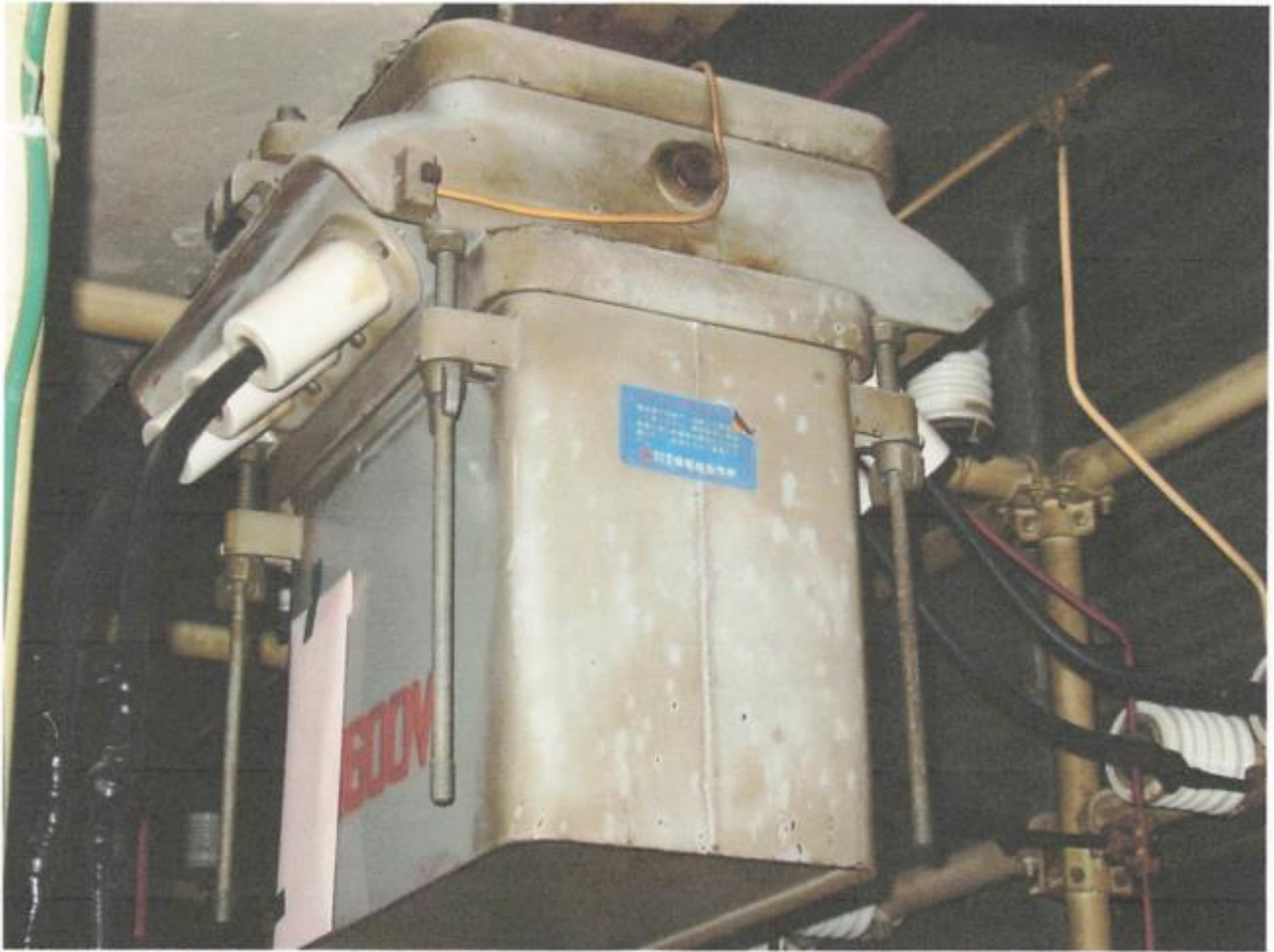
柱上油入開閉器
