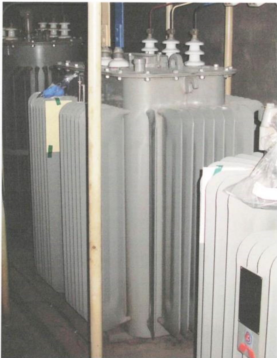
電灯変圧器 (200KVA)
