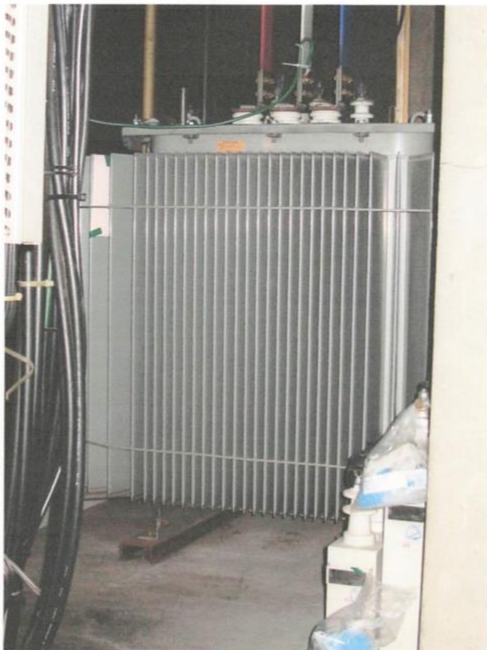
動力変圧器 (500KVA)
