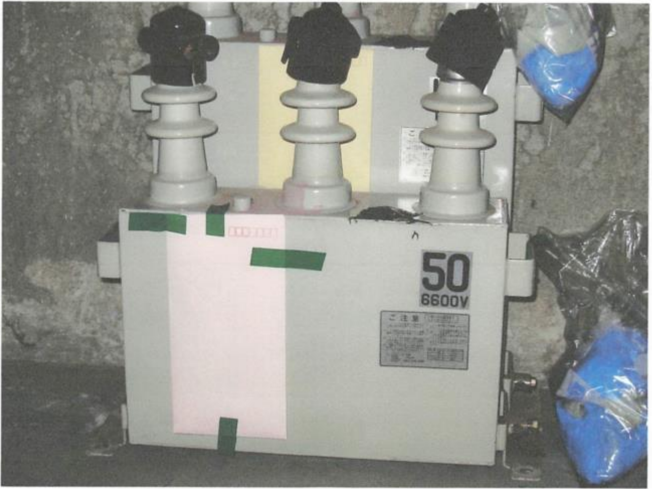
(50KVAコンデンサ)
