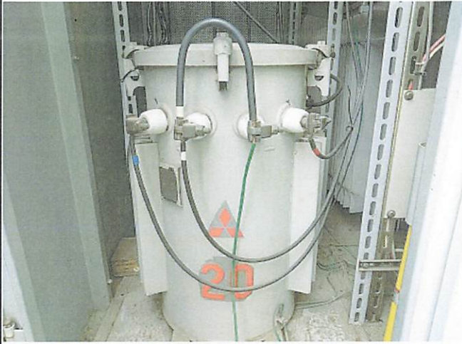
変圧器(5-001) 使用中(外観写真)
