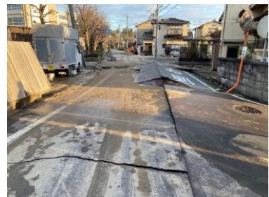
液状化被害（令和6年能登半島地震）
