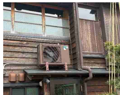
室外機の修景
