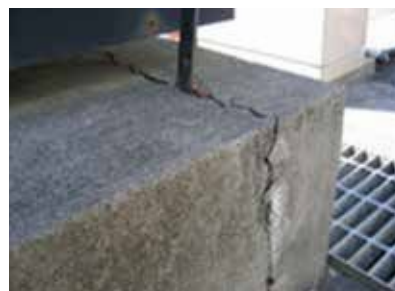
看板基礎のひび割れ
