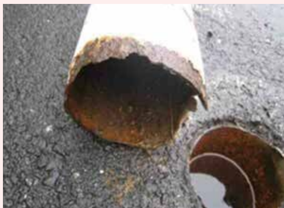
ポールの根腐れによる倒壊
