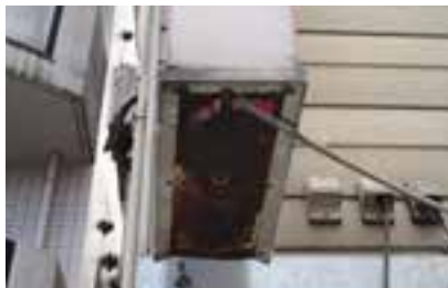
広告物内部は水がたまりやすく、錆びやすいです。
