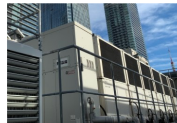
屋上の省エネ設備
