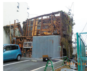
(神戸市内：台風による空き家の倒壊)
