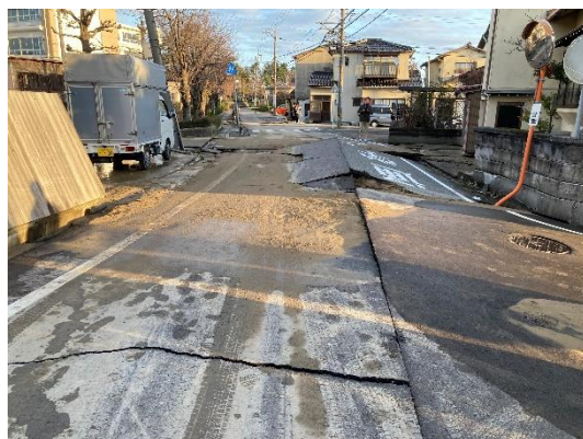
■ 地盤の液状化 (栗崎町地区) ■
