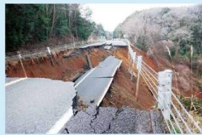
県内各地で道路が崩落し、奥能登へのアクセスルートが遮断 県が管理する道路では最大42路線87カ所で通行止め(令和6年1月4日時点)
