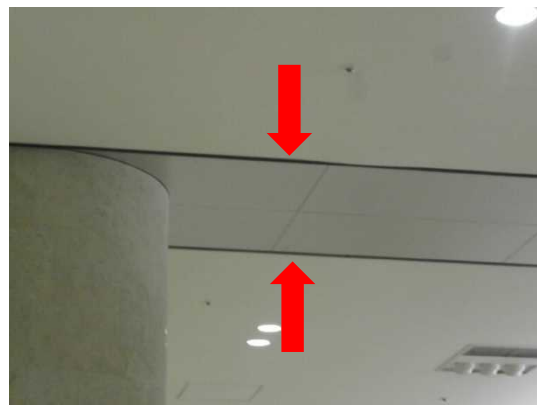
金属部分横のすき間
