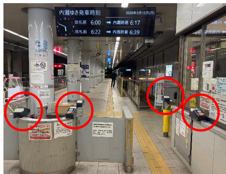
有人駅設置 入出場用端末 乗降人員に応じ複数通路分設置
