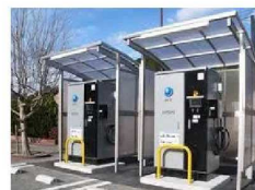
充電施設 蓄電池
