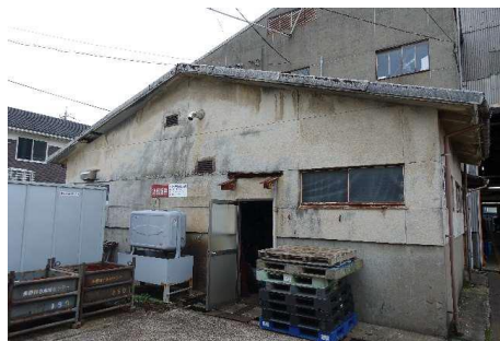
築50年以上経過し、建物躯体や外壁等が劣化した鶴来車両工場
