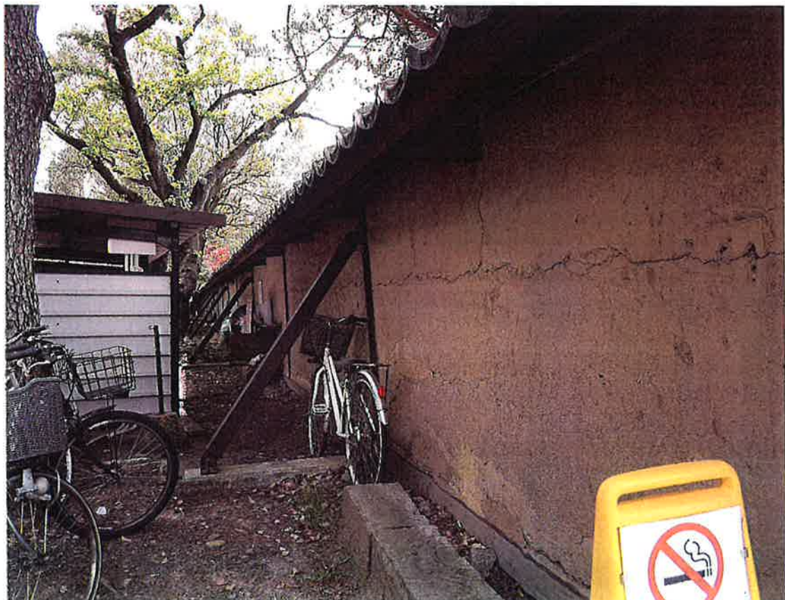
写真6 正面門右側土塀 敷地側
