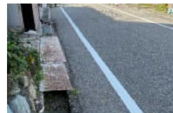
白線を設置した経緯を確認し、白線の除去を検討（市）
