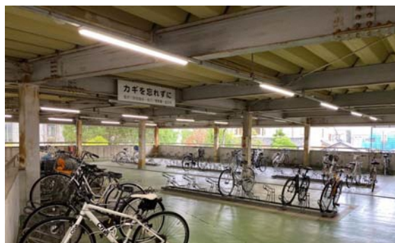
＜駐輪場照明の LED 化（西金沢駅）＞
